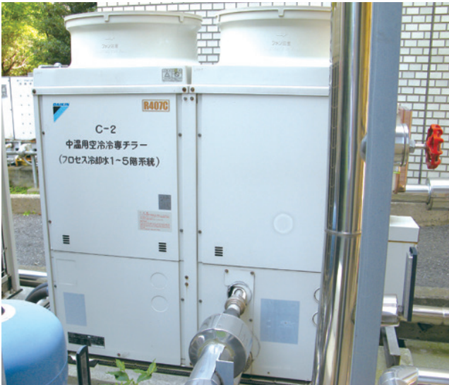
総合研究棟の冷却水循環装置 実験装置冷却用の水を循環させることにより、水使用量の削減を図っています。
