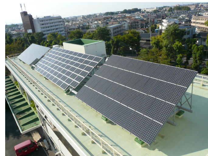
キャンパス内の太陽光発電設備
