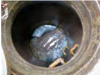
侵入した木の根で閉塞状態の排水桝内
