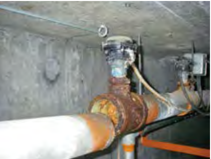
腐食による給水主管断裂状況
