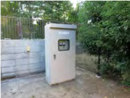
井戸用制御盤 (教育井戸)
