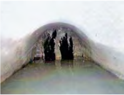
木の根による管路の閉塞状況2
