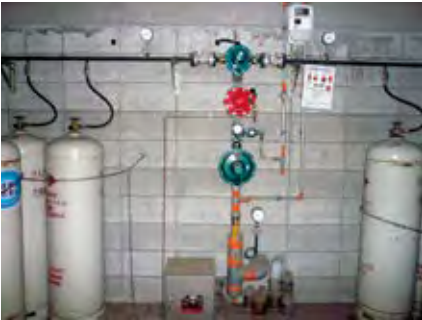
ボンベ庫内の圧力調整器
