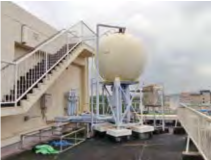
老朽化したFRP製の水槽
