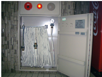
1号消火栓（2人以上で操作）
