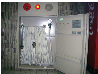
1号消火栓（2人以上で操作）
