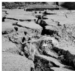
液状化による地割れ
