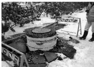
マンホールの浮き上がり
