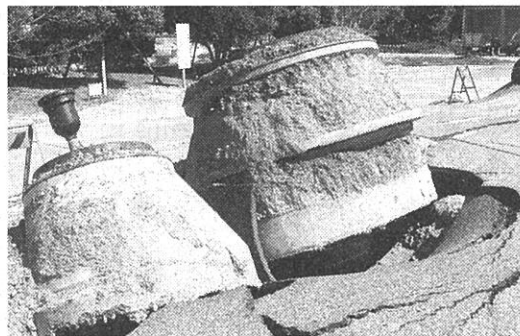
液化化現象で浮き上がったマンホール
