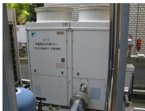
総合研究棟のチラー本体
