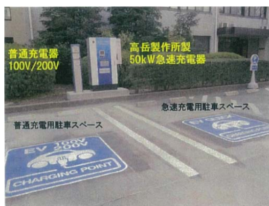
EV・PHEV 用充電ステーション
